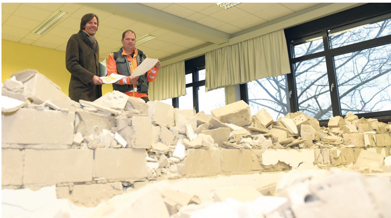
Die Wände werden eingerissen, und das Gebäude wird entkernt: Initiator Knut Bettels (links) und Bauleiter Oliver Neuber begutachten den Fortschritt im Gebäude am Bischofskamp. FOTO: KOLBE
